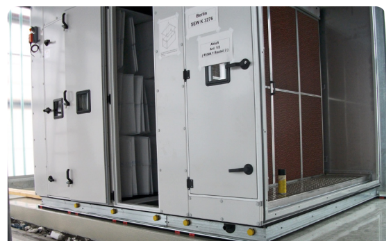
Versch. Technikzentralen der BAM, Berlin, Deutschland
